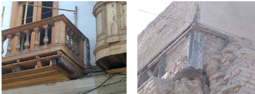
Figura 5: a) Encuentro entre encadenado y vigas del balcón en casa del Centro Histórico de Lima (foto propia). b) Detalle típico del encuentro en caja y espiga del encadenado con las cerchas de una bóveda encamonada en Lima (foto propia).
